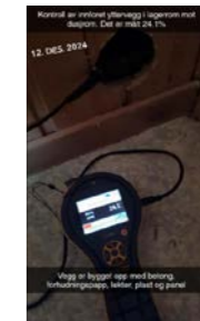
Kontroll av innforet yttervegg i lagerrom mot dusjrom. Det er målt 24,1%. Vegg er bygget opp med betong, forhudningspapp, leter, plast og panel.
