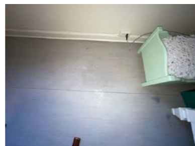
Synlig sprekk og slitasje på belegg inne på soverom 1
