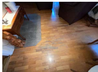
Slitasje på parkett stue
