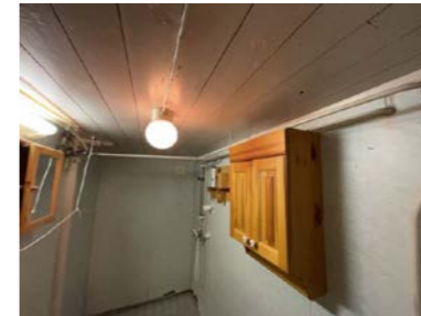
Åpne rør inne på dusjrom
