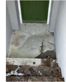
Sprekk i betongdekke foran dør i kjeller.
