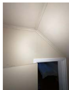
Sprekk i plateskjøt på soverom 2
