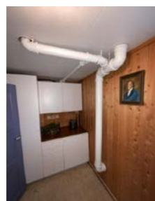
Avløpsrør i plast fra bad i 1. etasje og ut av bolig.
