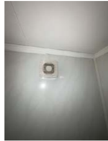
Mekanisk avtrekksvifte på vegg
