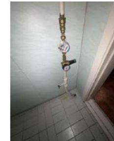
Hovedstoppekrane med reduksjonsventil og vannmåler
