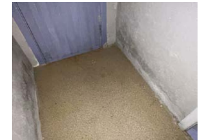
Synlig saltutslag/misfarging på vegg i kjeller ved utgang
