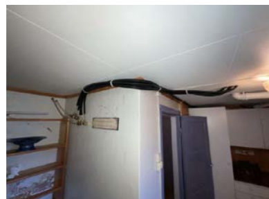
Åpne rør og fordelerkolber montert på vegg
