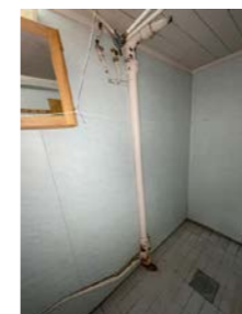
Åpen avløpsrør inne på dusjrom i kjeller
