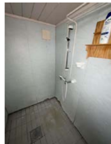
Oversikt mot dusj og skadde plater
