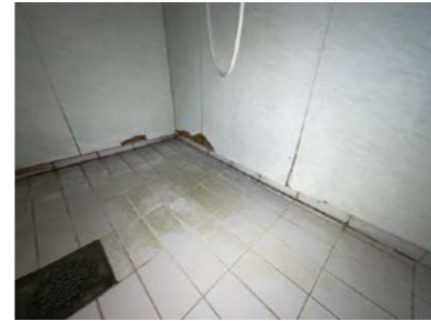
Synlige skader på våtromsplater
