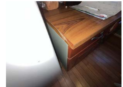
Skade på kantlist benkeplate
