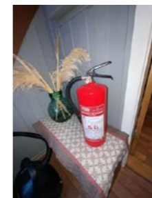
Brannslukker fra 2015 i gang ved sikringskapet.
