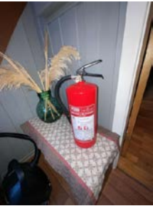
Brannslukker fra 2015 i gang ved sikringsskapet.
