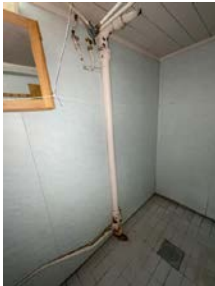
Åpen avløpsrør inne på dusjrom i kjeller
