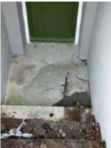
Sprekk i betongdekke foran dør i kjeller.
