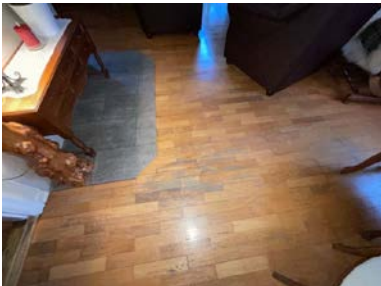
Slitasje på parkett stue
