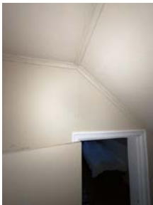
Sprekk i plateskjøt på soverom 2
