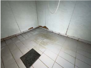
Synlige skader på plater i dusj
