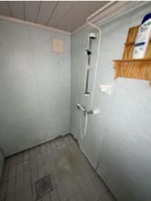
Oversikt mot dusj og skadde plater
