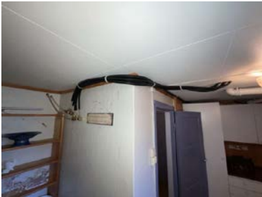
Åpne rør og fordelerkolber montert på vegg
