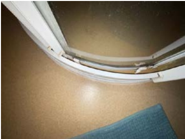
Ett hjul på dusjdør er skadet/borte
