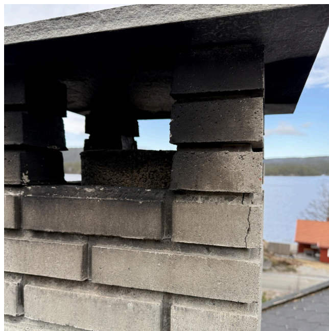
Sprekk i det øverste skiftet.
