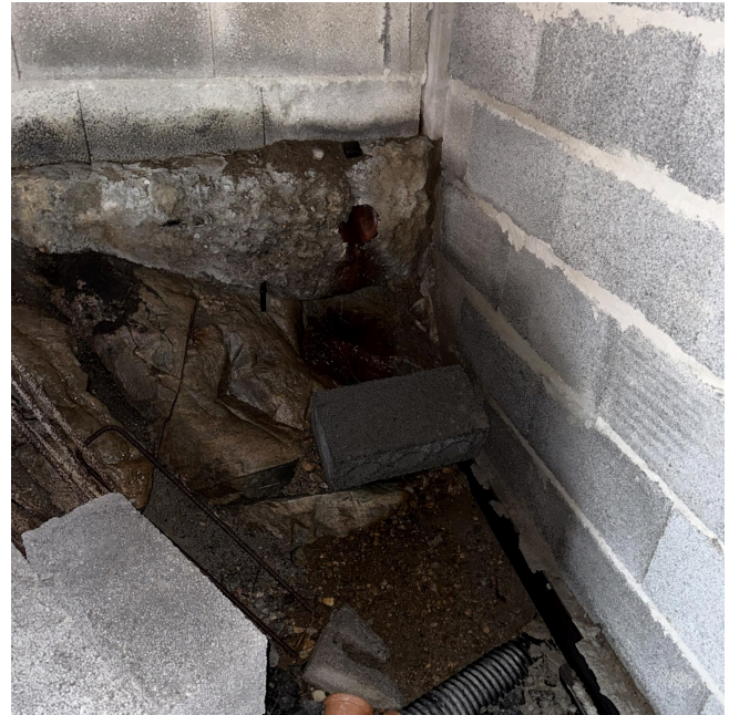
Fuktige murer og synlig drensør i gulv og rør igjennom mur i sørvest.
