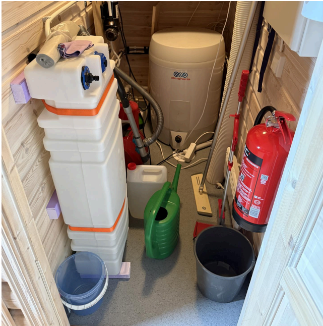
Hyttevannsystem er montert i bod.
