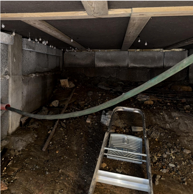
Fuktige murer og synlig fjell.
