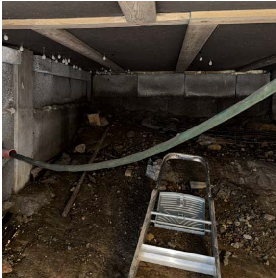
Fuktige murer og synlig fjell.
