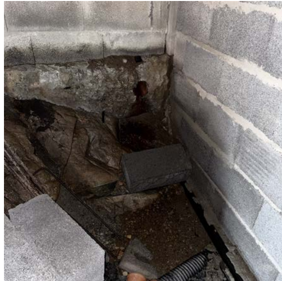
Fuktige murer og synlig drenerør i gulv og rør igjennom mur i sørvest.
