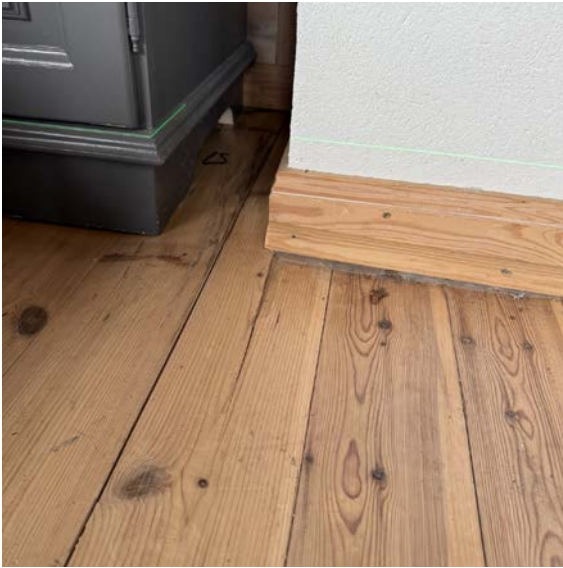
Ujevnhet i gulvet ved pipe og sprekk i gulvbord.
