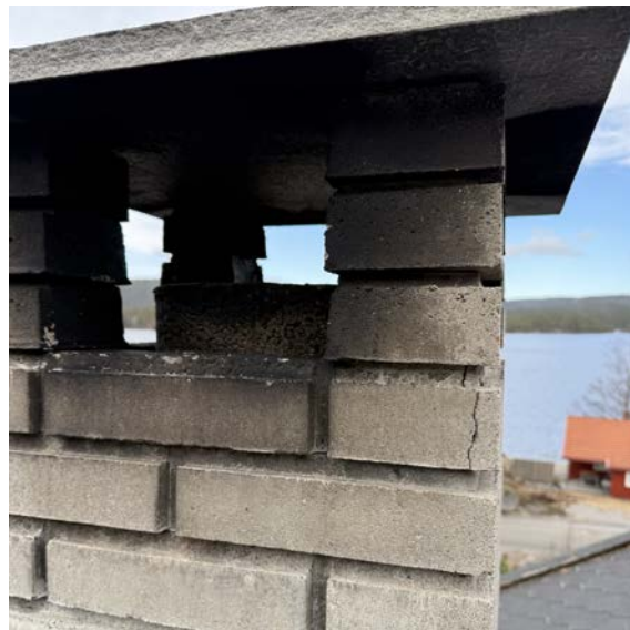
Sprekk i det øverste skiftet.
