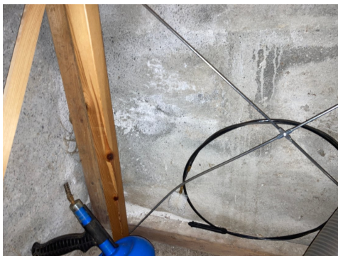
Riss/sprekk i golv
