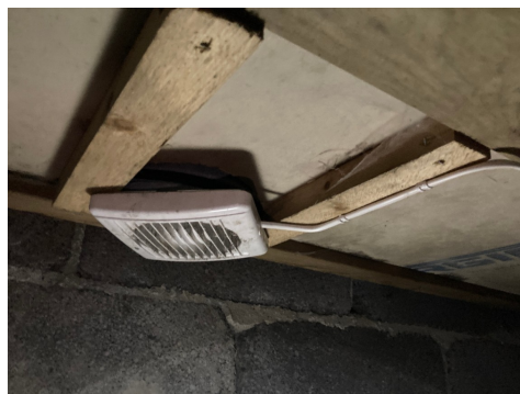
El-avtrekk i blindkjeller
