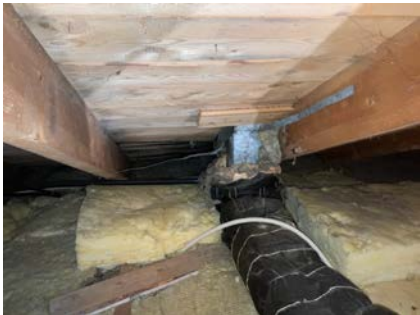
Fukt nedre del av tak ved luftekanal
