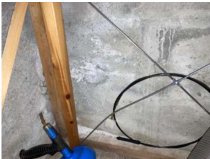
Riss/sprekk i golv
