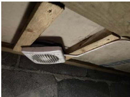
El-avtrekk i blindkjeller
