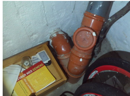
Plastrør med stakeluke.
