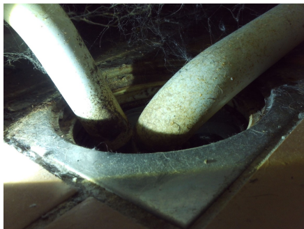
Sluk under dusjkabinett.
