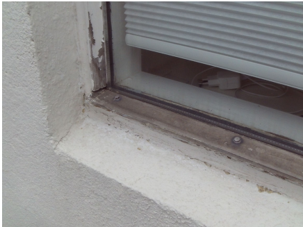
Slitt på utvendig karm og ramme.
