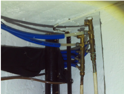
Deler av rør i rør uten fordelerskap.
