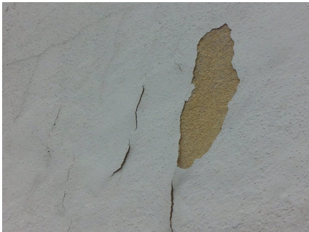
En del sprekker i maling på fasader.
