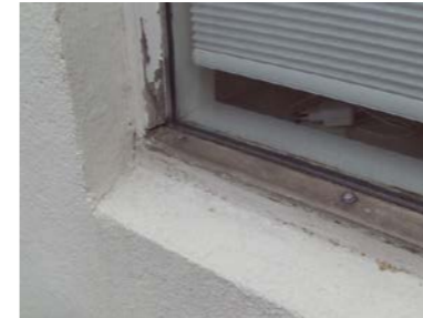
Slitt på utvendig karm og ramme.
