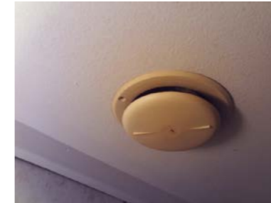
Ventil i himling med naturlig avtrekk.
