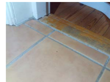
Ingen oppkant ved dør.
