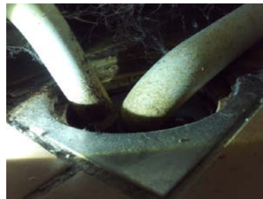
Sluk under dusjkabinett.
