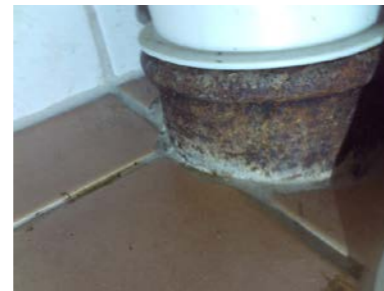
Usikker tetting i rundt opprinnelig avløpsrør fra toalettet
