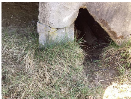
Sprekk i fundament på veranda mot sør.
