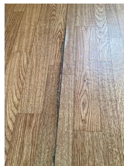
Slitasje og gulvbelegg som slipper i skjøt.
