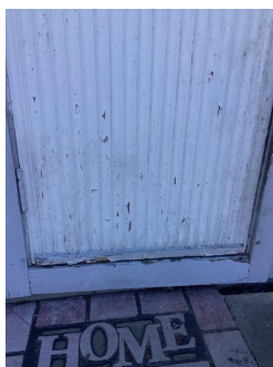
Eksempel på slitasje på sekundærdør.
