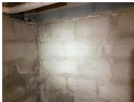
Eksempel på innvendig sprekk i grunnmur.
