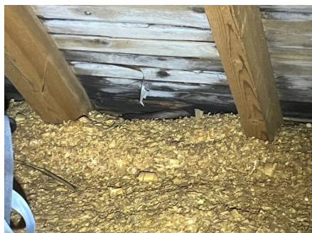
Mulig råte i taktro på loft.
