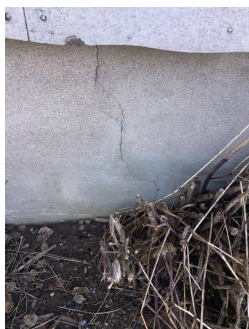
Eksempel på utvendig sprekk i grunnmur.
