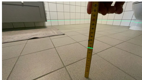
Målt gulvområde med motfall ved yttervegg siden av dør.
