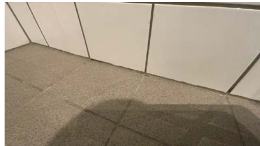
Bilde viser bemerket silikonfuge.
