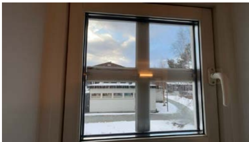
Bilde viser vindu på bad
