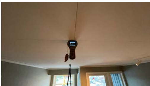
Utført fuktmåling ved fuktmerker.
