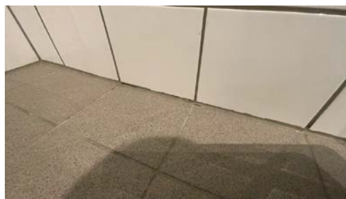
Bilde viser bemerket silikonfuge.
