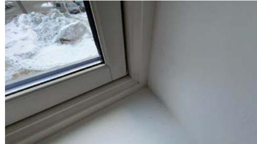
Utett mellom karm og vindu.
