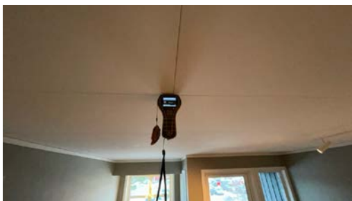
Utført fuktmåling ved fuktmerker.
