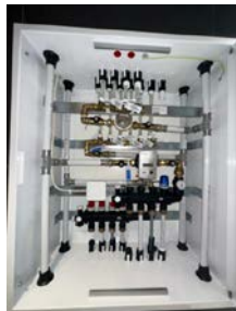
Samleskap med rørkurser og stoppekraner leilighet
