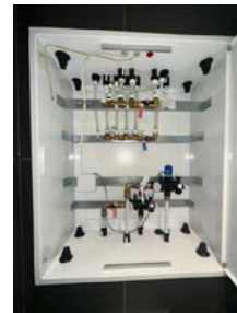
Samleskap med rørkurser og stoppekraner hybel
