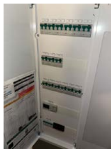
Sikringsskap med automatsikringer.
