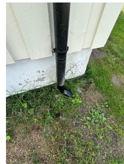
Takvann ledes stedvis ikke bort fra grunnmur.
