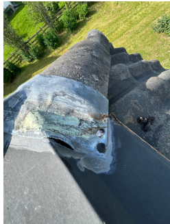
Hull i blybeslag ved altan over stue.
