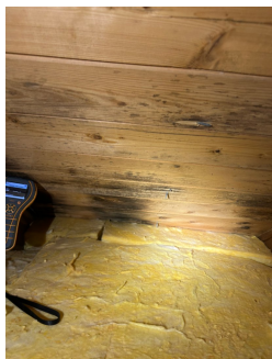
Svertesopp i undertak. Det er ikke synlig lufting av takkonstruksjonen.
