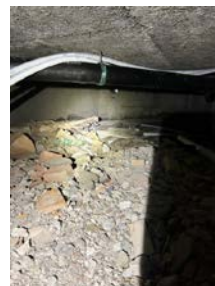
Krypekjeller med organiske materialer og manglende fuktsperre mot grunn.
