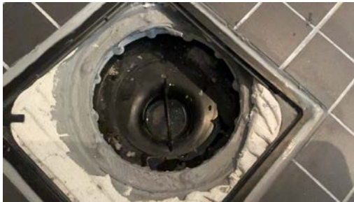
Sluk i dusjsone. Bad 2. Etasje.
