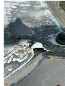
Hull i blybeslag ved altan over stue.
