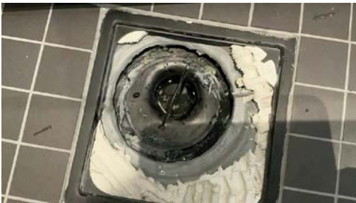
Sluk i dusjsone.
