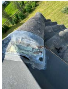
Hull i blybeslag ved altan over stue.
