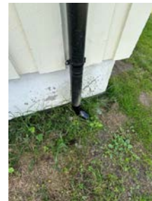
Takvann ledes stedvis ikke bort fra grunnmur.
