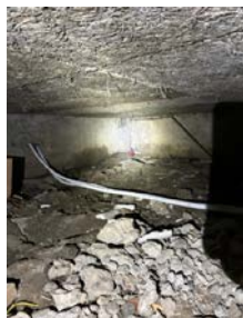
Krypekjeller med organiske materialer og manglende fuktsperre mot grunn.
