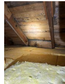
Svertesopp i undertak. Det er ikke synlig lufting av takkonstruksjonen.
