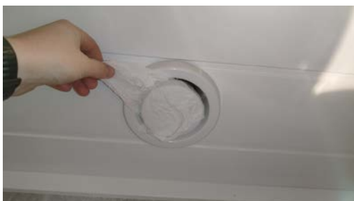
Test av avtrekket.
