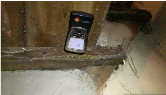
Begynnende fuktskader og vått treverk på trapp.
