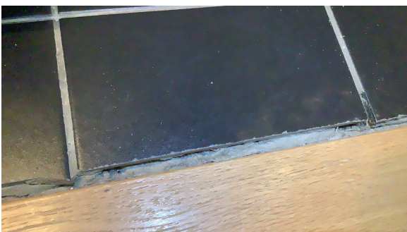
Mangelfull avslutning mellom gulvfliser og dørterstel.
