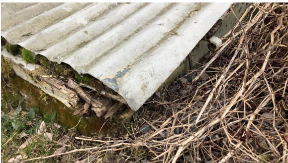
Råteskadet svill og manglende hengsel.
