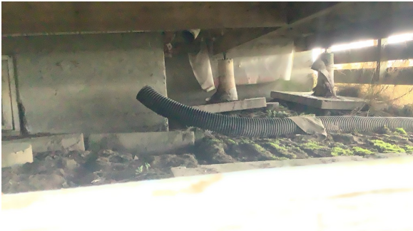
Rør på terreng har løsnet fra nedløpsrør.
