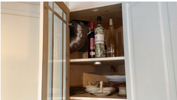
Pipevange er innkledd bak kjøkkenskap.
