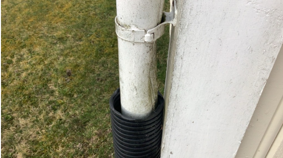
Eksempel på skadet nedløpsrør.
