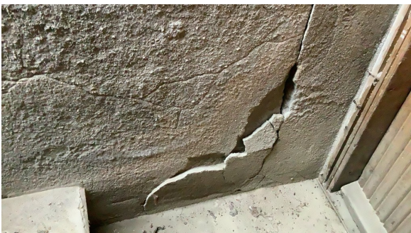
Sprekkdannelser i murt/støpt vange.
