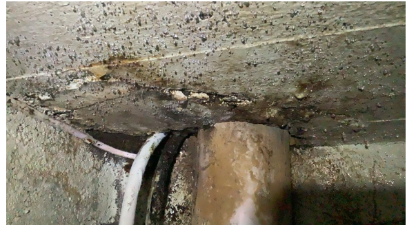
Vanndråpe på undersiden av støpt dekke i kjeller.
