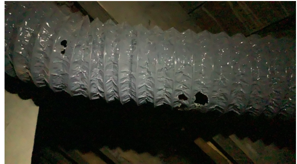
Hull i ventilasjonsrør fra avtrekksvifte på bad.
