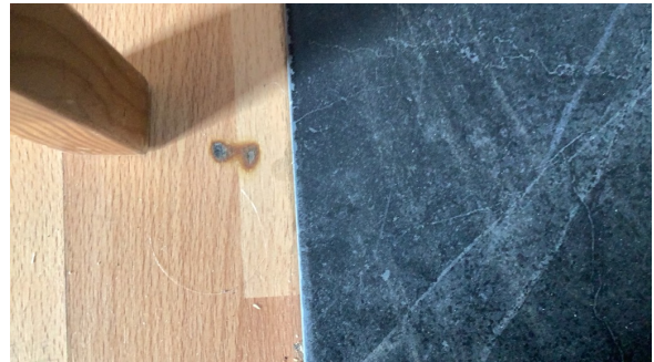
Svimerke i laminatgulv.
