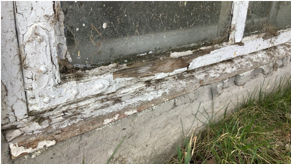
Eksempel på værslitt kjellervindu.
