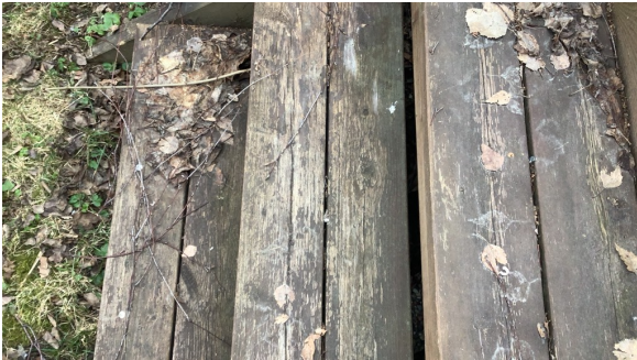
Eksempel på værslitte trinn i trapp.
