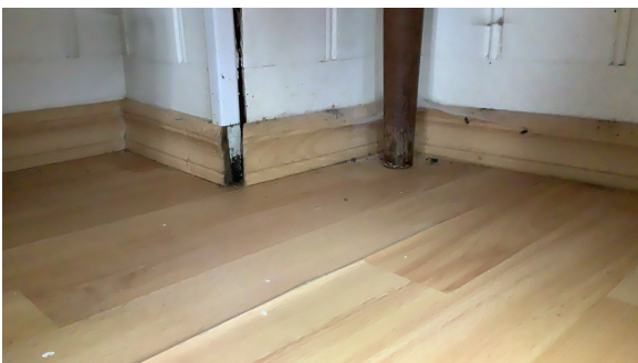
Svellskader i veggplater og laminatgulv i stue.
