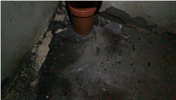
Vann på gulv under rør i kjeller.
