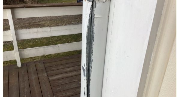
Eksempel på frostsprengt nedløpsrør
