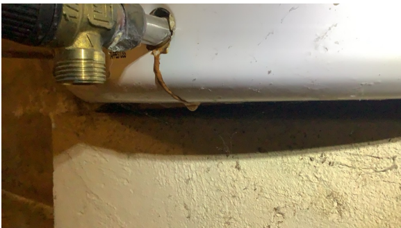
Lekkasje fra varmtvannstanken.
