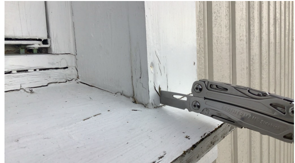
Omramming er ført helt ned til vannbrett, og dette har ført til spredte råteskader.
