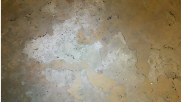
Eksempel på saltutslag på gulv.
