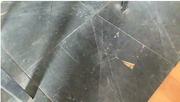
Sprukne gulvfliser under ildsted.
