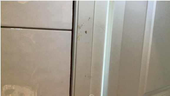
Manglende avslutning av veggfliser mot dør.
