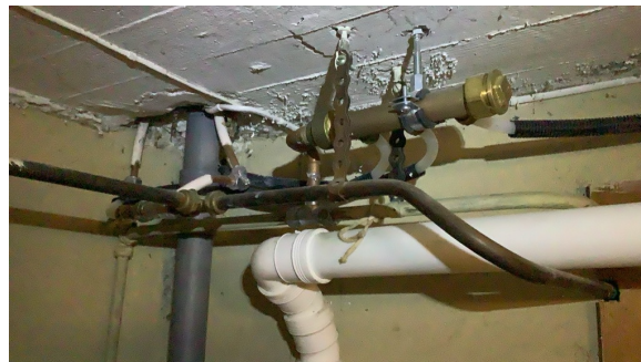
Eventuelt lekkasjevann fra rør i rør system ledes til kjellerrom uten sluk
