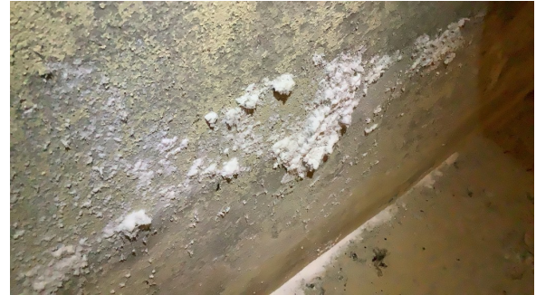
Eksempel på saltutslag på grunnmur.
