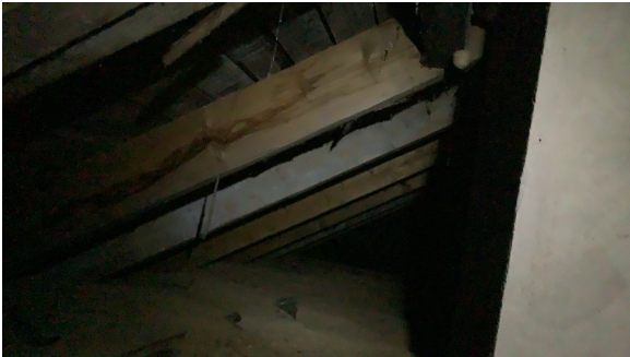
Fuktskjolder på takspærre nedenfor pipe.
