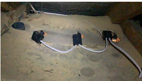
Manglende dampsperre og isolasjon ved spoter.
