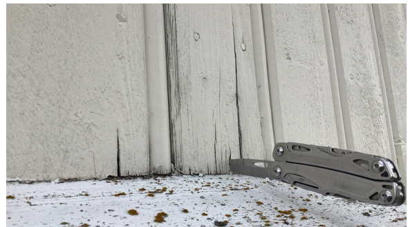
Kledning er ført helt ned til vannbrett over vindu, og dette har ført til spredte råteskader.
