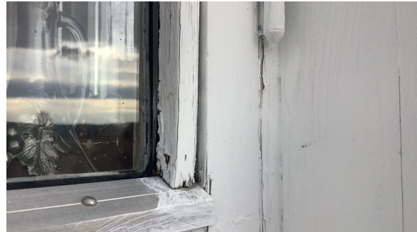
Råteskadet glasslist på vindu.
