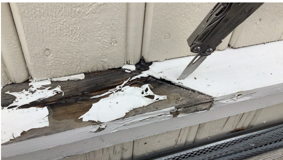
Råteskadet vannbrett i etasjeskillet.
