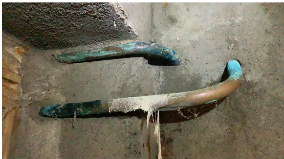
Eksempel på irring på rør.
