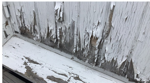
Fuktskadet dør i andre etasje.
