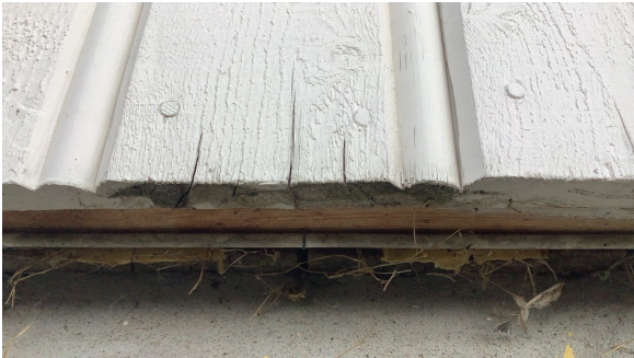
Kledningens endeved er ikke behandlet, og denne har noe oppsprekking.
