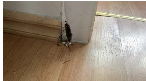
Råteskadet karmlist på åpning.
