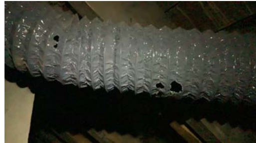
Hull i ventilasjonsrør fra avtrekksvifte på bad.
