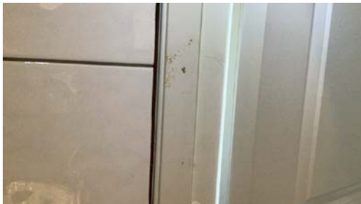
Manglende avslutning av veggfliser mot dør.
