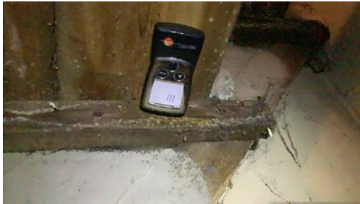
Begynnende fuktskader og vått treverk på trapp.
