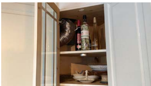
Pipevange er innkledd bak kjøkkenskap.
