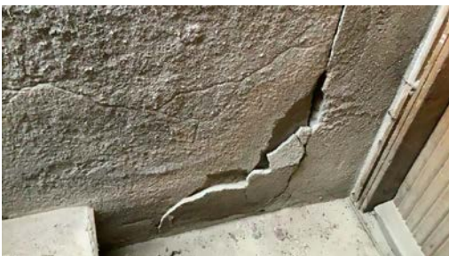
Sprekkdannelser i murt/støpt vange.
