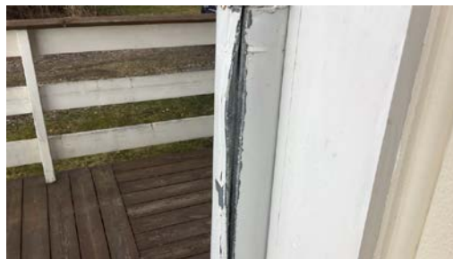
Eksempel på frostsprengt nedløpsrør
