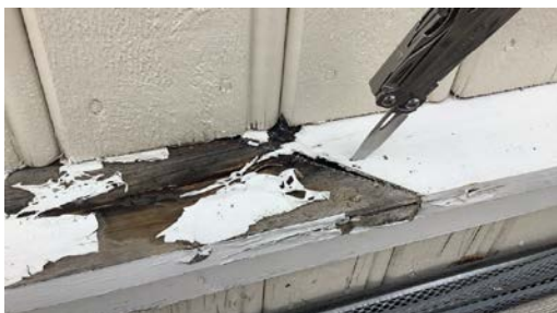
Råteskadet vannbrett i etasjeskillet.
