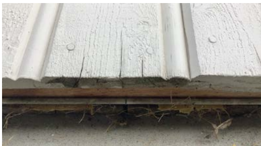
Kledningens endeved er ikke behandlet, og denne har noe oppsprekking.
