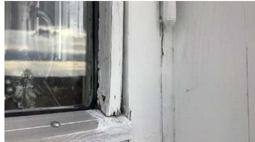
Råteskadet glasslist på vindu.
