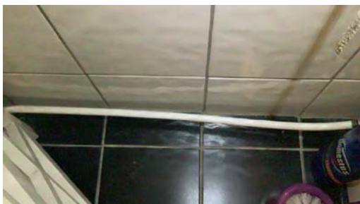
Ufagmessig montering av vannrør da dette ikke er klamret.
