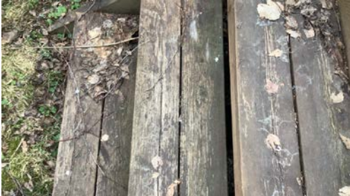
Eksempel på værslitte trinn i trapp.
