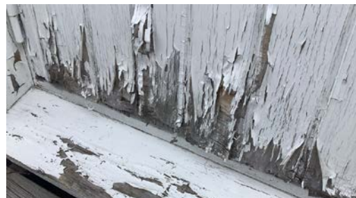
Fuktskadet dør i andre etasje.
