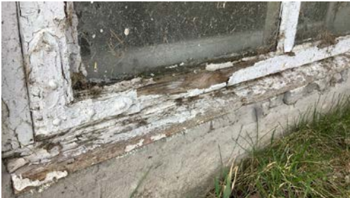
Eksempel på værslitt kjellervindu.
