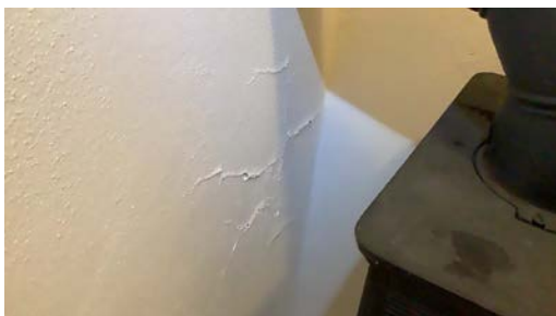
Sprukket maling på pipe.
