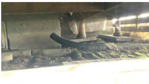
Rør på terreng har løsnet fra nedløpsrør.
