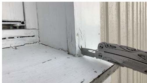
Omrømming er ført helt ned til vannbrett, og dette har ført til spredte råteskader.
