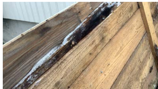
Fuktskader i treverk på lem.
