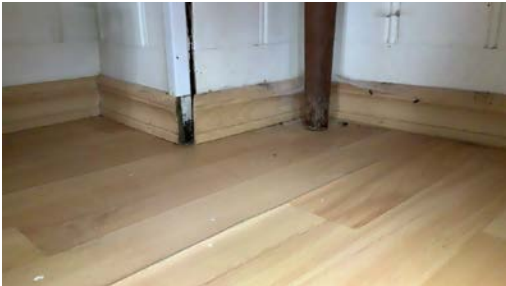
Svellskader i veggplater og laminatgulv i stue.
