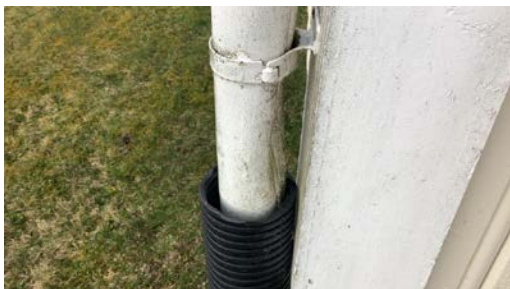
Eksempel på skadet nedløpsrør.
