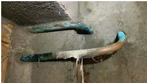
Eksempel på irring på rør.
