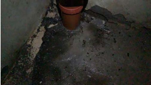
Vann på gulv under rør i kjeller.
