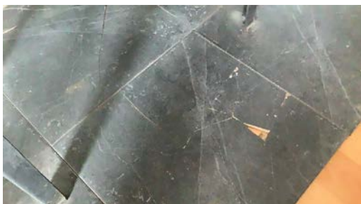
Sprukne gulvfliser under ildsted.
