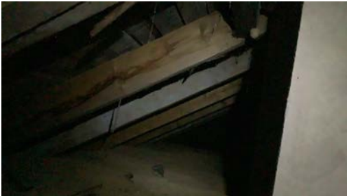
Fuktskjolder på takspærre nedenfor pipe.
