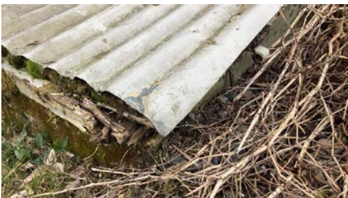
Råteskadet svill og manglende hengsel.
