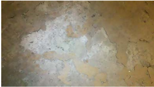
Eksempel på saltutslag på gulv.
