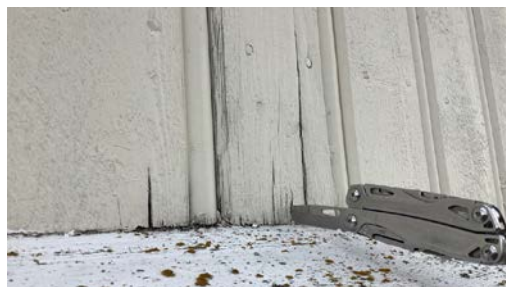
Kledning er ført helt ned til vannbrett over vindu, og dette har ført til spredte råteskader.
