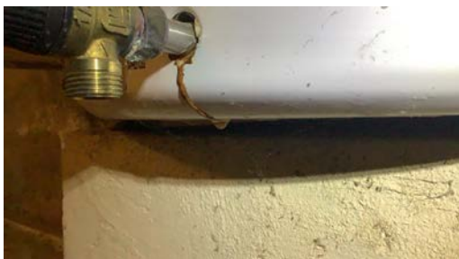
Lekkasje fra varmtvannstanken.
