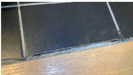
Mangelfull avslutning mellom gulvfliser og dørterskel.
