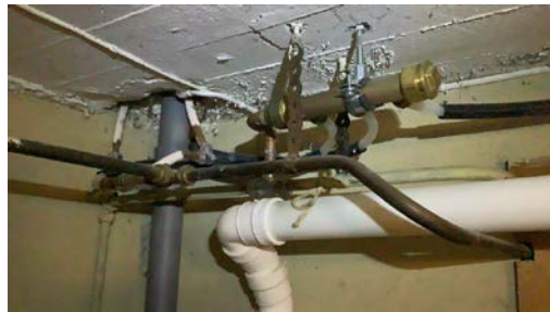
Eventuelt lekkasjevann fra rør i rør system ledes til kjellerrom uten sluk
