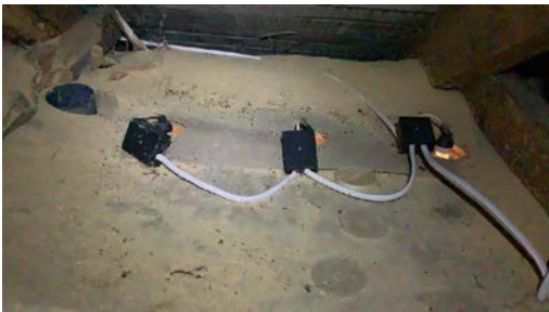
Manglende dampsperre og isolasjon ved spoter.
