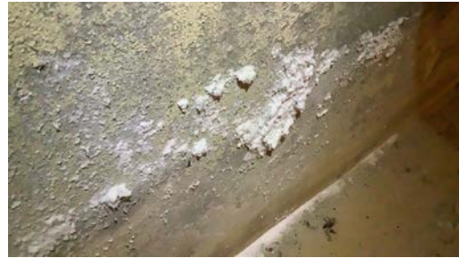
Eksempel på saltutslag på grunnmur.
