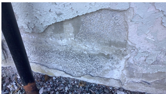
Område med løsnet puss.
