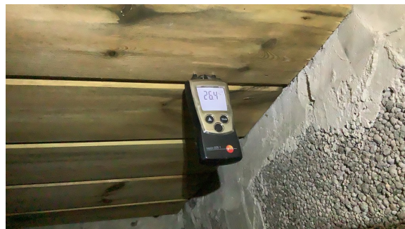
Det måles skadelig fuktinnhold i himling.
