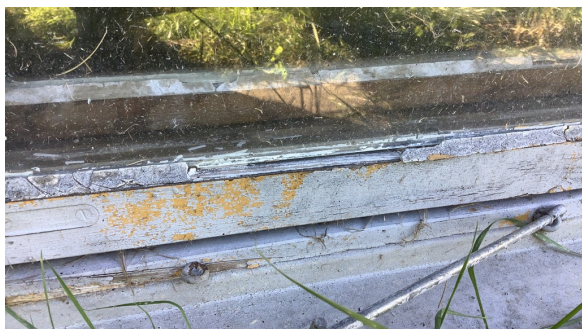
Eksempel på værslitt kjellervindu.
