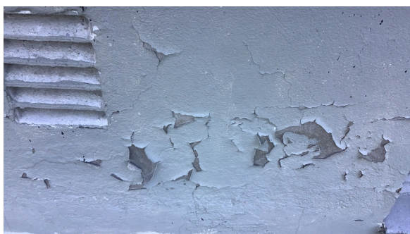
Eksempel på område med løsnet maling.
