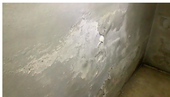
Eksempel på saltutslag på murvegg.
