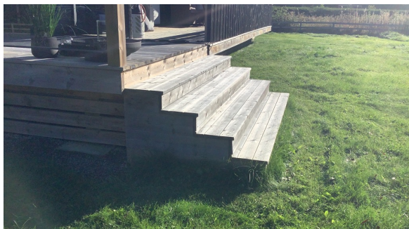
Trapper mangler rekkeverk.
