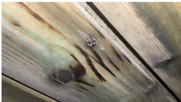
Tegn til soppdannelse i himling.
