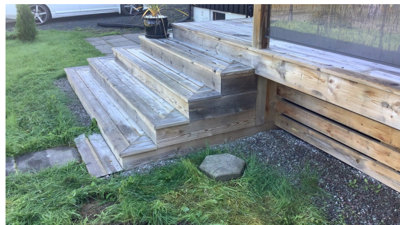
Trapper mangler rekkeverk.
