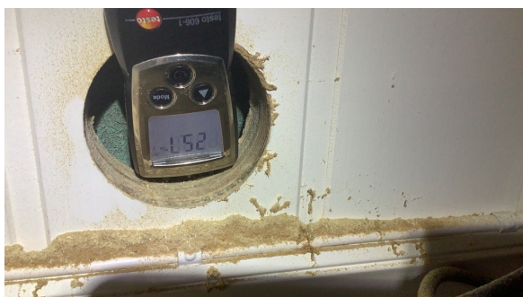
Hulltaking, og det måles skadelig fuktnivå.
