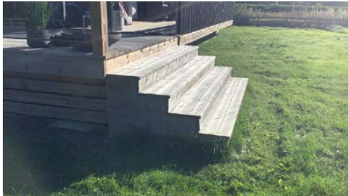
Trapper mangler rekkverk.
