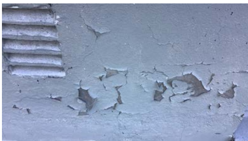
Eksempel på område med løsnet maling.
