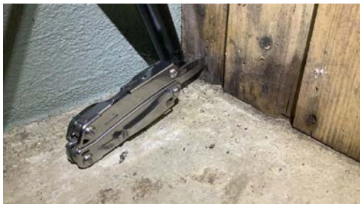
Råteskadet panel på delevegg mellom boder.
