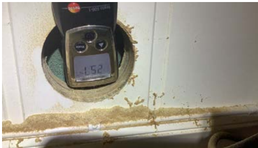
Hulltaking, og det måles skadelig fuktnivå.
