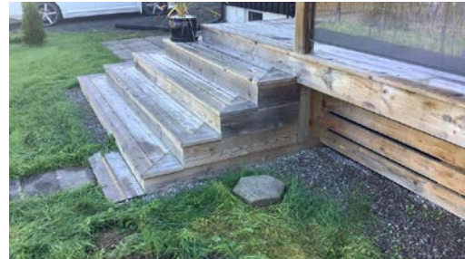
Trapper mangler rekkverk.
