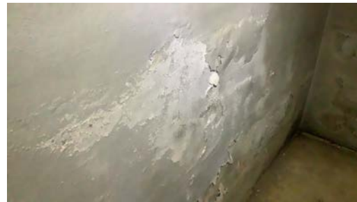
Eksempel på saltutslag på murvegg.
