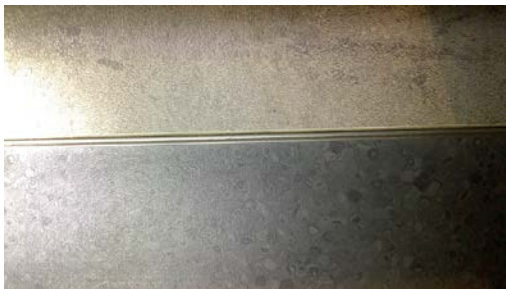
Glippe mellom sokkellist og baderomsplate er ikke fuget.
