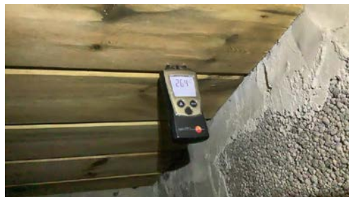
Det måles skadelig fuktinnhold i himling.
