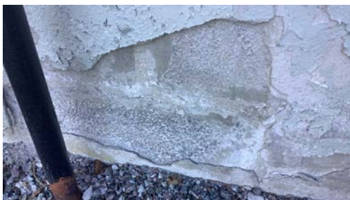
Område med løsnet puss.
