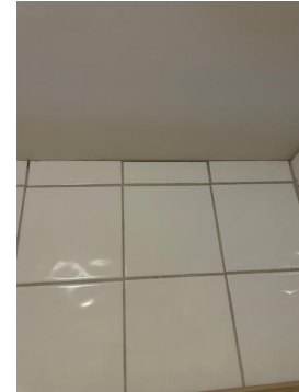
Eksempel på ufagmessige fuger
