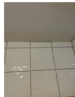
Eksempel på ufagmessige fuger
