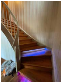
Manglende håndløper på vegg.
