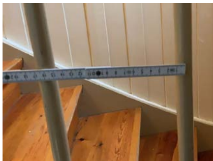
Åpning i rekkverk på 15 cm.
