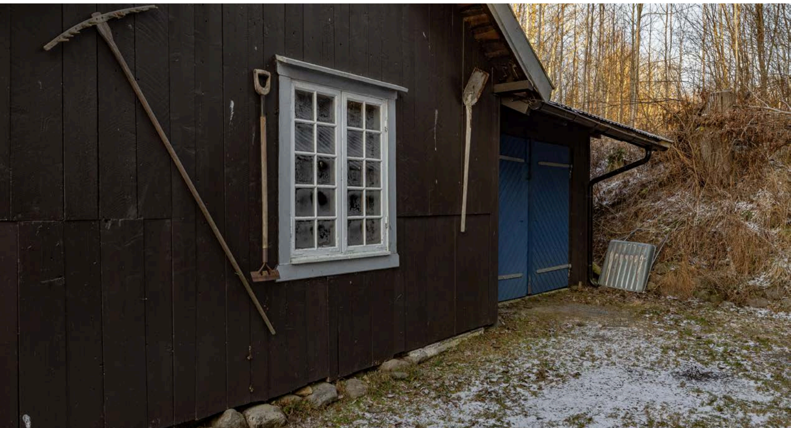
Eldre uthus generelt med preg etter aldersforvitring og noe manglende vedlikehold.
