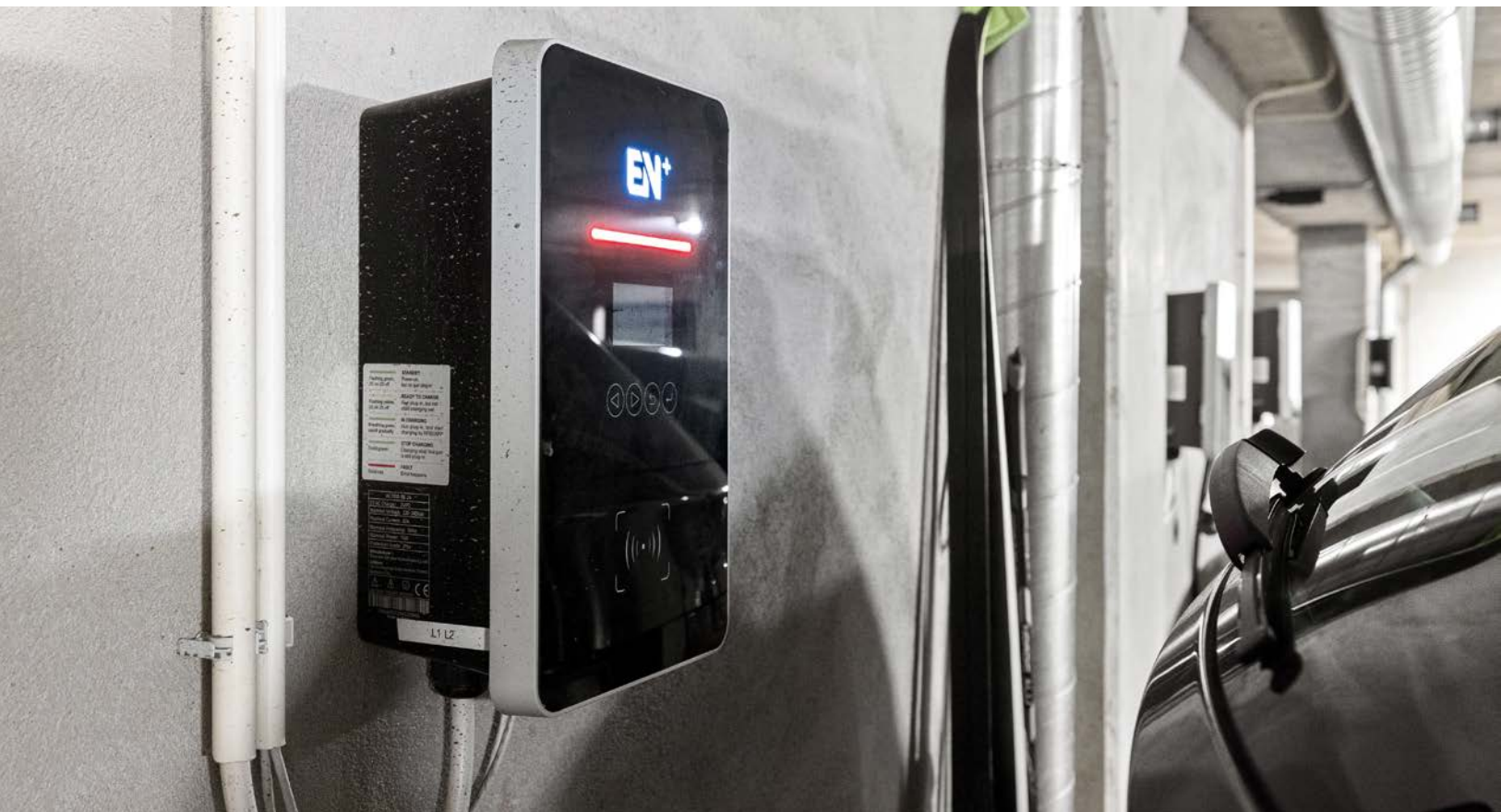
På garasjeplassen er det montert ladeboks for el-bil.
