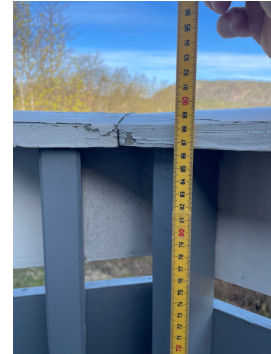
Rekkverk veranda under 100 cm
