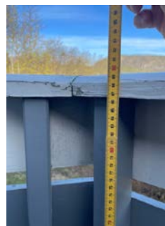
Rekkverk veranda under 100 cm
