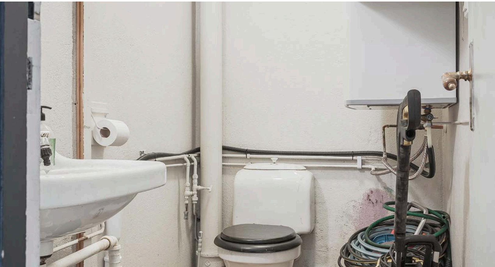
Toalettrom utstyrt med vegghengt servant, gulvstående toalett og varmtvannsbereder.
