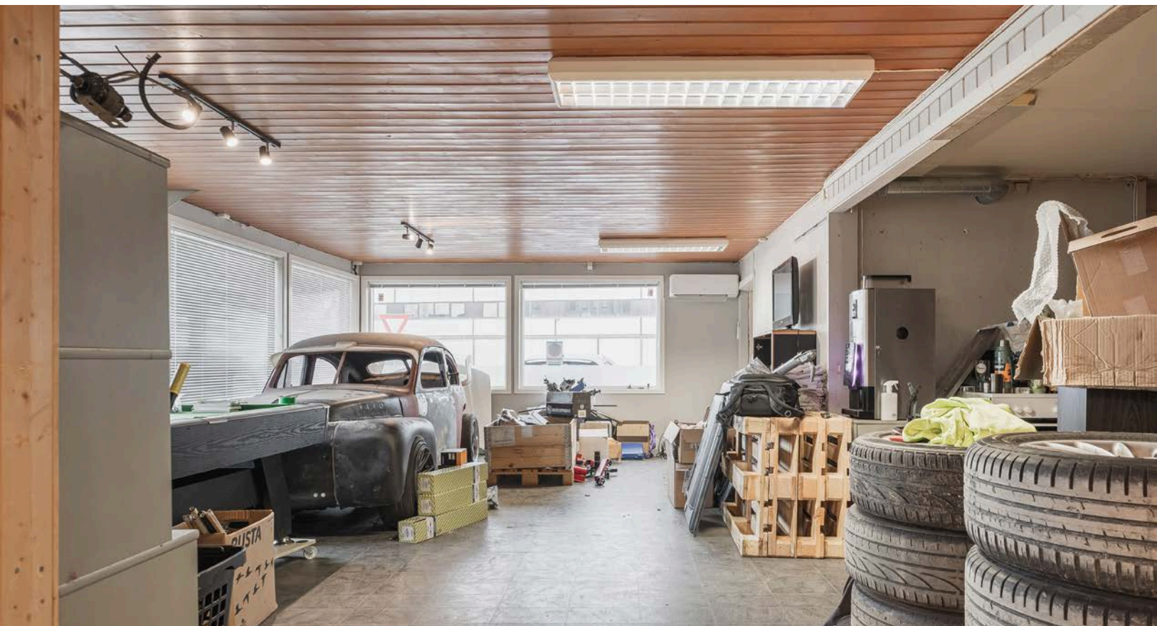
Oppvarming med luft-til-luft varmepumpe og panelovner.
