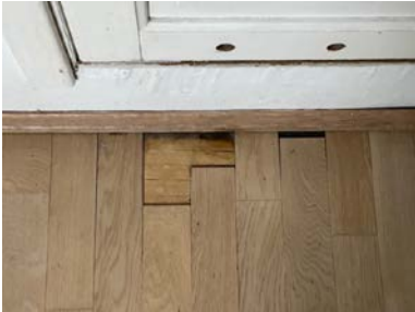
Skade på parkett utenfor ett av badene i 1. etasje.
