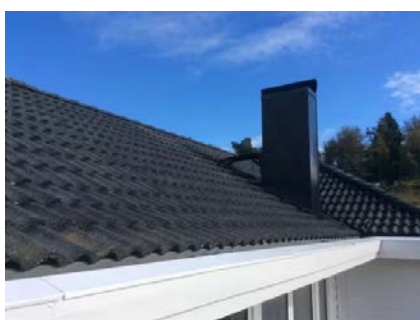
Yttertak. Inntekket pipe.
