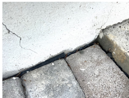
Synlig løst tettesjikt. Yttervegg v/trapp til kjeller - vestside.
