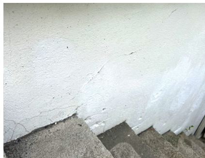
Mindre riss/sprekker ved utvendig kjellertrapp- vestside.
