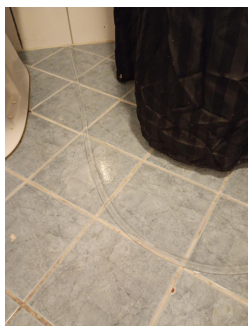
Mottatt bilde: Vannstoppelist på gulv og fjernet svertesopp.
