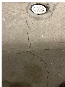
Sprekker i støpt dekke- teknisk rom i kjeller.
