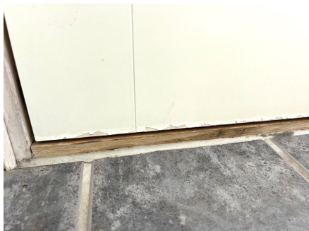
Svelling i nedkant soveromsdør.
