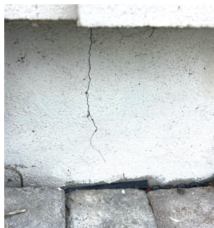
Mindre riss/sprekk ved utvendig kjellertrapp- vestside.
