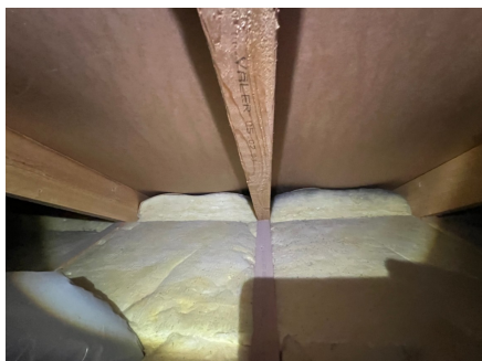
Raftepapp bøyer seg opp mot undertak.
