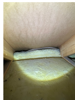
Raftepapp bøyer seg opp mot undertak.
