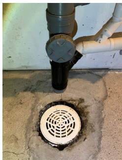
Sluk og stakeluke i teknisk rom.
