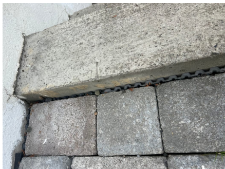
Synlig løst tettesjikt. Trapp til kjeller - vestside.
