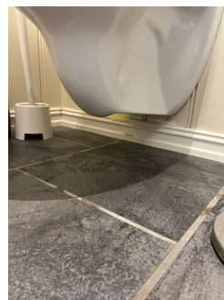
Under veggmontert toalett. Ingen lekkasjesikring.
