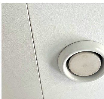
Hovedbad 2. Etag: Eldre kondens/fuktmerker i fm ventil i himling.
