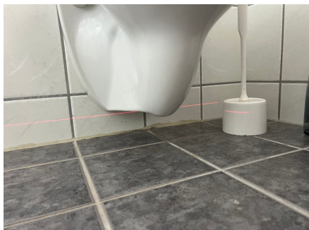
Under toalettet. Ingen lekkasjesikring..
