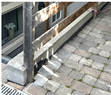
Synlig løst tettesjikt. Trapp til kjeller - østside.
