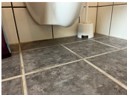
Under toalett. Ingen synlig lekkasjesikring.
