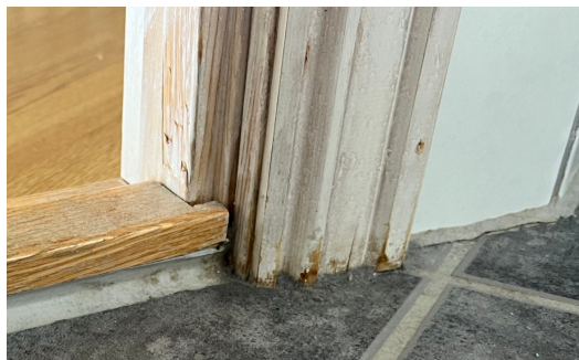
Opptrekk av fukt i dørlister.
