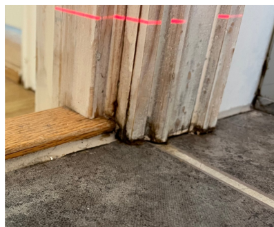
Opptrekk av fukt i nedkant dørlist.
