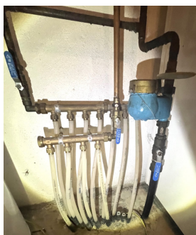
Vanninntak/Stoppekraner. Fordelerstokker rør i rør.
