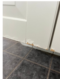
Svelling/skader i nedkant dører på innredning.
