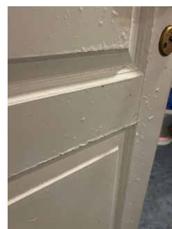
Svelling/Fuktskader på baderomsdør.
