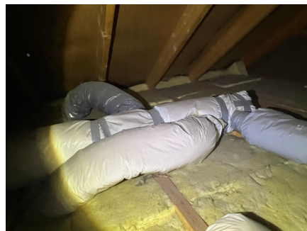
Diverse ventilasjonsrør på loft.
