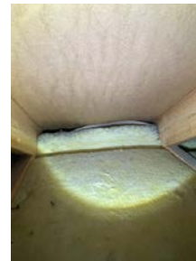
Raftepapp bøyer seg opp mot undertak.
