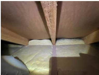
Raftepapp bøyer seg opp mot undertak.
