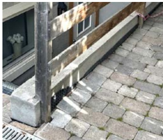
Synlig løst tettesjikt. Trapp til kjeller - østside.
