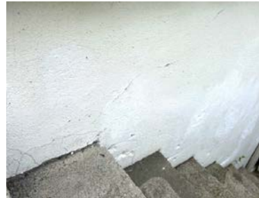
Mindre riss/sprekker ved utvendig kjellertrapp- vestside.
