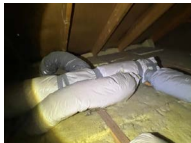
Diverse ventilasjonsrør på loft.
