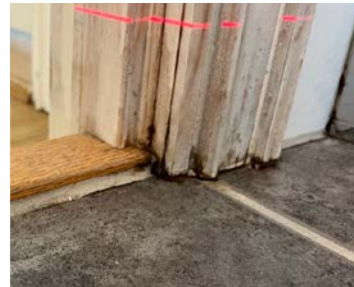
Opptrekk av fukt i nedkant dørlist.
