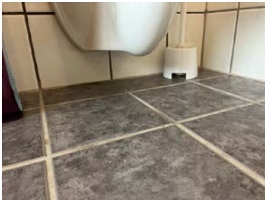
Under toalett. Ingen synlig lekkasjesikring.
