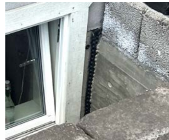
Synlig løst tettesjikt. Lysbrønn.
