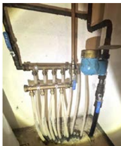
Vanninntak/Stoppekraner. Fordelerstokker rør i rør.
