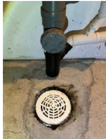
Sluk og stakeluke i teknisk rom.
