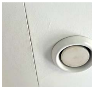
Hovedbad 2. Etg: Eldre kondens/fuktmerker i fm ventil i himling.
