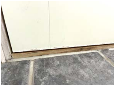
Svelling i nedkant soveromsdør.
