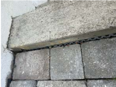
Synlig løst tettesjikt. Trapp til kjeller - vestside.
