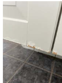
Svelling/skader i nedkant dører på innredning.
