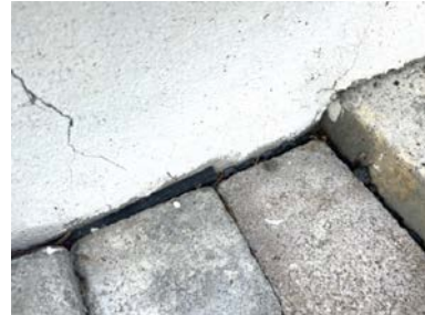
Synlig løst tettesjikt. Yttervegg v/trapp til kjeller - vestside.
