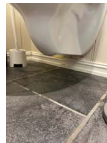
Under veggmontert toalett. Ingen lekkasjesikring.
