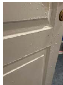
Svelling/Fuktskader på baderomsdør.
