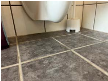
Under toalett. Ingen synlig lekkasjesikring.
