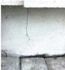
Mindre riss/sprekk ved utvendig kjellertrapp- vestside.
