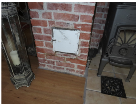
Sotluke uten ubrennbar plate til gulv.
