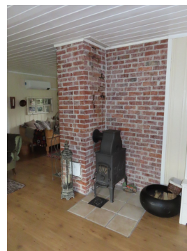
Vedovn som fyringskilde i stue.
