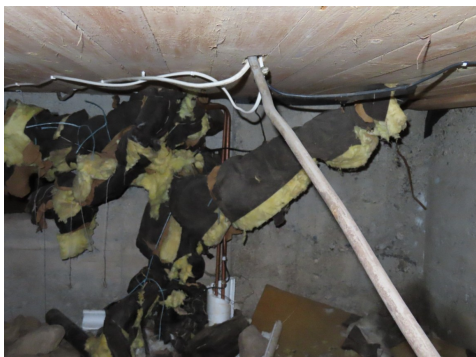
Eldre, åpent etablert vann og avløpssystem. Kobberstrekk.
