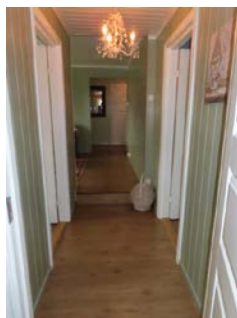
Gang mellom opprinnelig og ny del - nivåsprang i gulv. Skjevheter påvist i tilbygd del.
