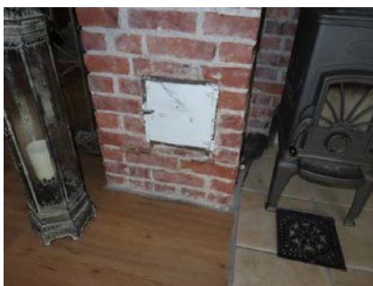
Sotluke uten ubrennbar plate til gulv.
