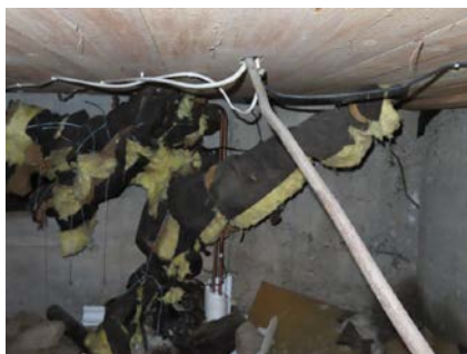
Eldre, åpent etablert vann og avløpssystem. Kobberstrekk.
