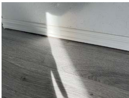
Glippe mellom list og gulv ved pipe.
