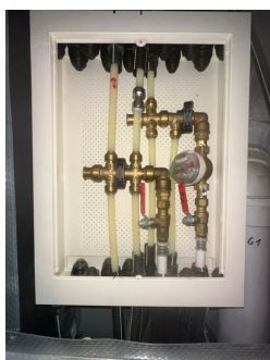
Samleskap med rørkurser og stoppekraner
