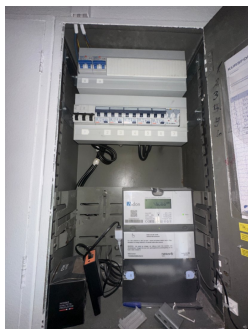
Sikringsskap med automatsikringer.
