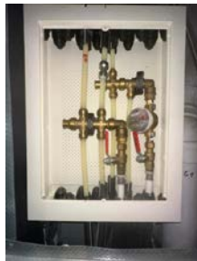
Samleskap med rørkurser og stoppekraner
