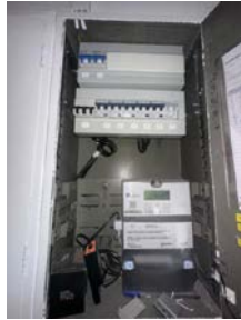
Sikringsskap med automatsikringer.
