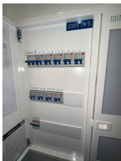
Sikringsskap med automatsikringer.
