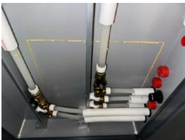
Stoppekraner plassert på bad
