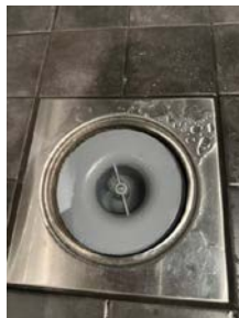
Sluk i plast med vannlås, plassert i dusjnisse
