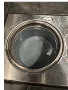
Sluk i plast, plassert i dusjnisse
