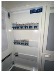
Sikringsskap med automatsikringer.
