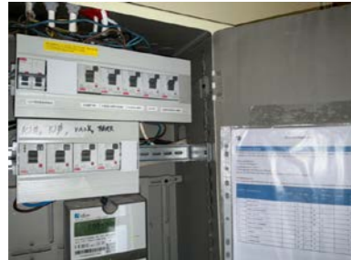
Automatsikringer i sikringsskap plassert i gang/fellesareal.
