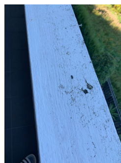
Etterslep av vedlikehold på rekkverk
