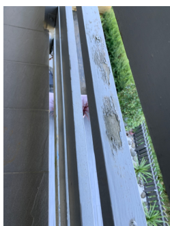
Etterslep av vedlikehold på rekkverk
