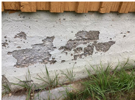
Eksempel på avskaling i grunnmur.
