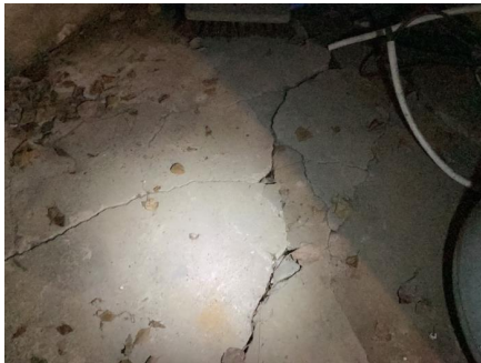
Oppsprekking i betonggulv.
