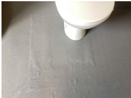
Skade i gulv ved toalett.
