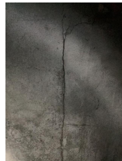
Eksempel på sprekk i grunnmur.
