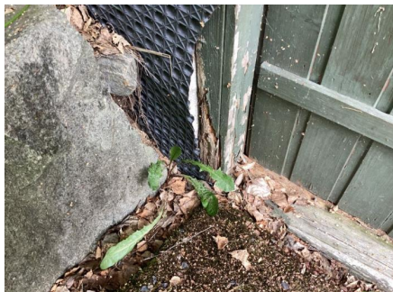
Råteskade på kjellerdør.
