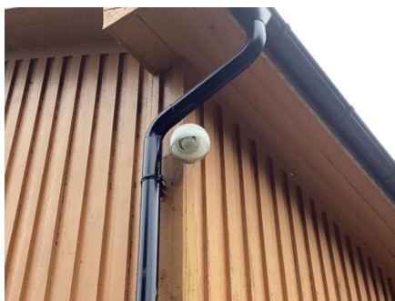
Skade på lyskuppel.
