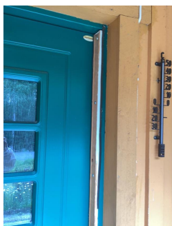
Det er montert ekstra list på utsiden av dør.
