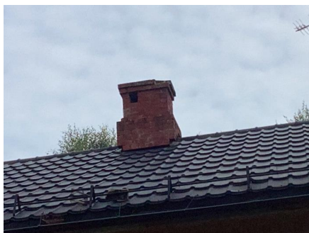
Det er noen skader på piper over tak.
