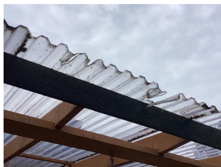
Noen skader på takplater.
