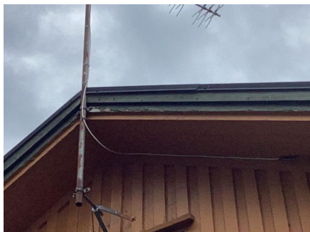
Eksempel på slitasje på vinds kier.
