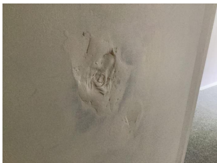
Skade på dør i 2. etasje.
