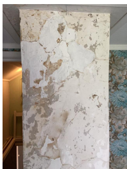
Kraftig slitasje på en pipe i 2. etasje.
