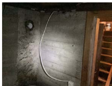
Manglende innfesting av strømkabel til stikkontakt ved varmtvannsbereder.
