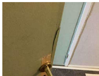
Skade på dør i 2. etasje.
