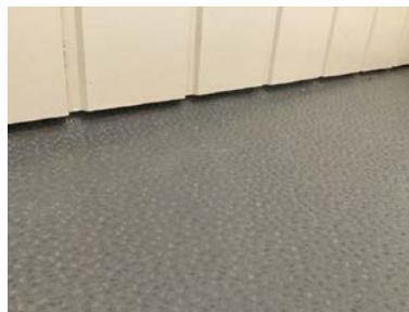
Trepanel går tett ned mot gulv.
