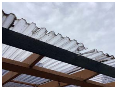
Noen skader på takplater.
