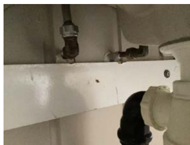
Det er ikke tette gjennomføringer.
