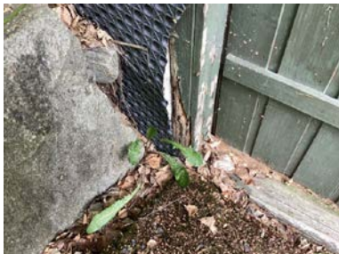
Råteskade på kjellerdør.
