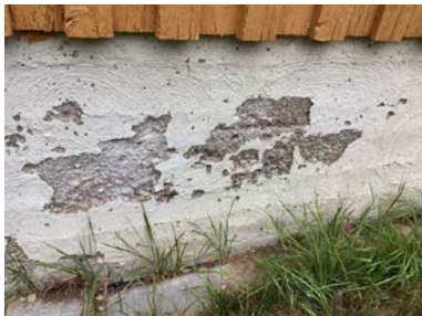
Eksempel på avskaling i grunnmur.
