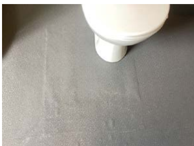
Skade i gulv ved toalett.
