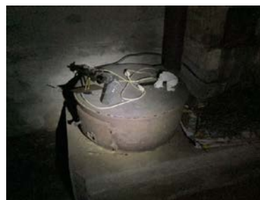
Eldre takke med ukjent tilstand i kjeller.
