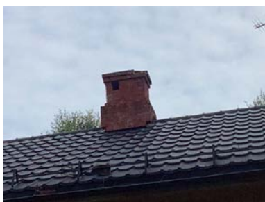
Det er noen skader på piper over tak.
