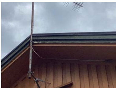
Eksempel på slitasje på vindszier.
