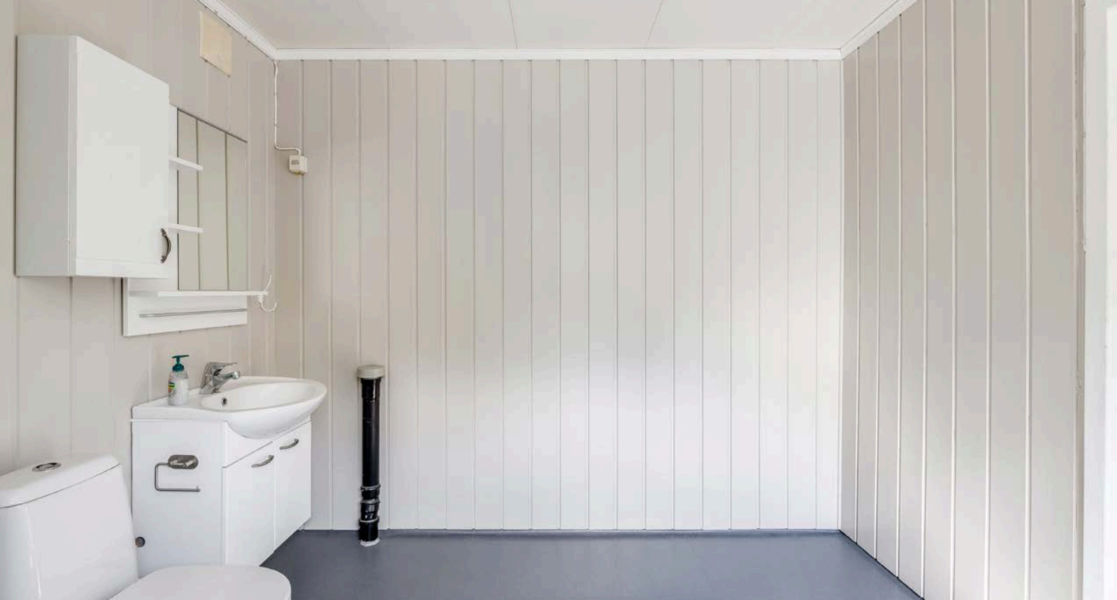
Påbegynt renovering av bad som ikke er ferdigstilt. Trepanel på vegger og takesplater i himling. Det ligger banemembran på gulv (ment for at fliser skal legges oppå).
