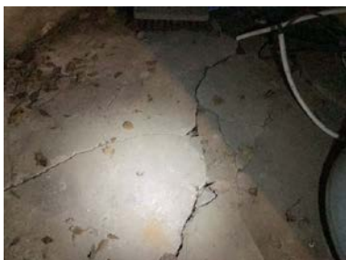
Oppsprekking i betonggulv.
