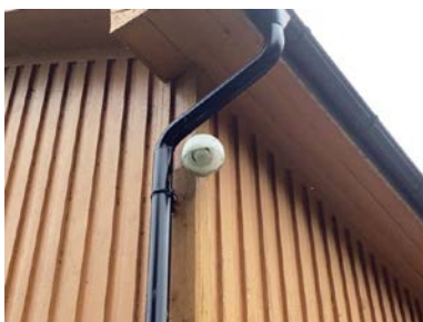
Skade på lyskuppel.
