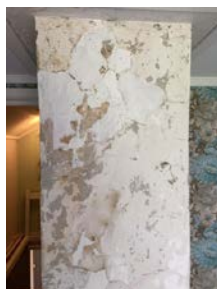
Kraftig slitasje på en pipe i 2. etasje.
