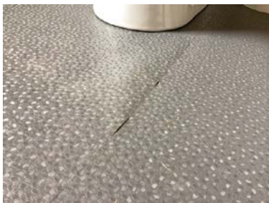
Banemembran løsner noen steder fra underlag.
