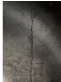
Eksempel på sprekk i grunnmur.
