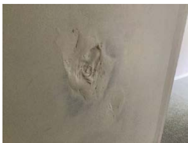
Skade på dør i 2. etasje.
