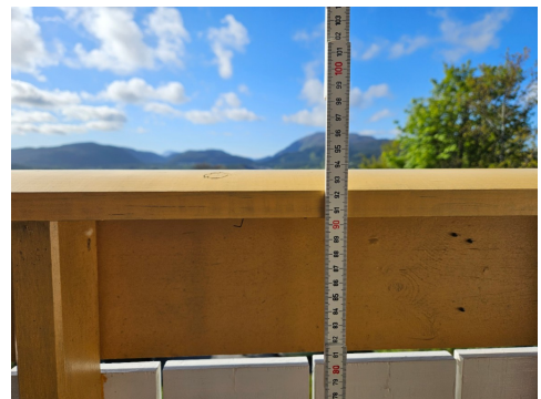
Rekkverk målt til 94 cm
