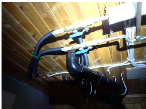
Rør i rør til opprinnelig kobberør på bod i kjeller.
