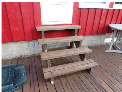
Trapp til terrassedør.
