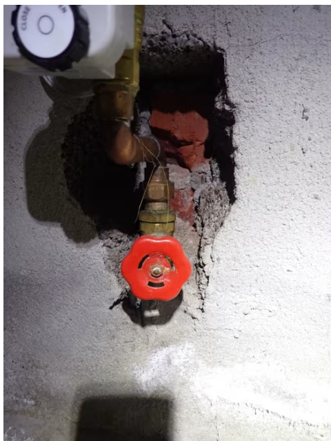
Stoppekrane i bod 3.
