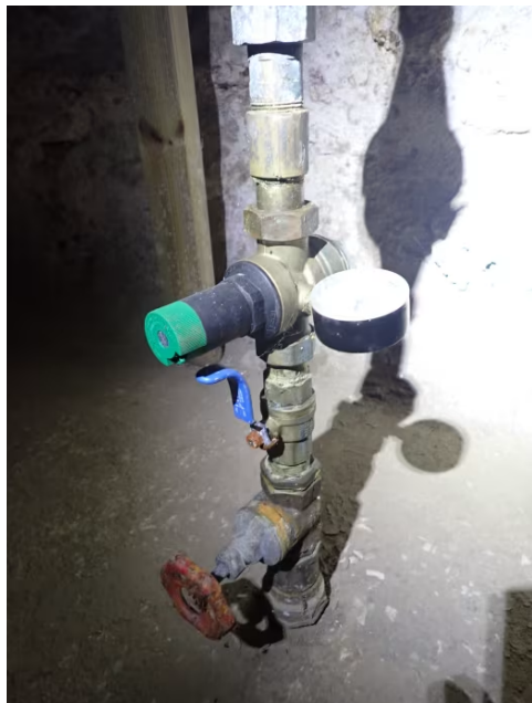
Stoppekrane i grovkjeller.
