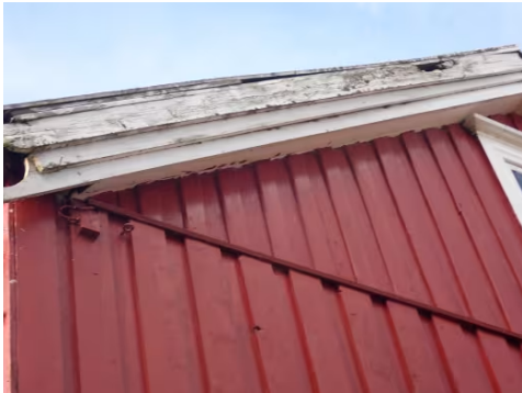
Vinds kier med råte.
