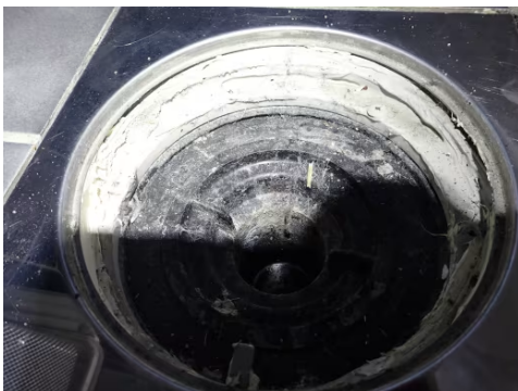
Sluk med synlig membran.
