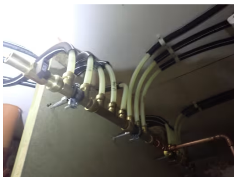
Rørfordeling i grovkjeller.
