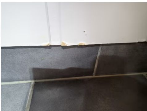
Fuktmerker på vegg under skyllekumme.
