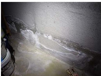
Salt/kalkutslag i overflater.
