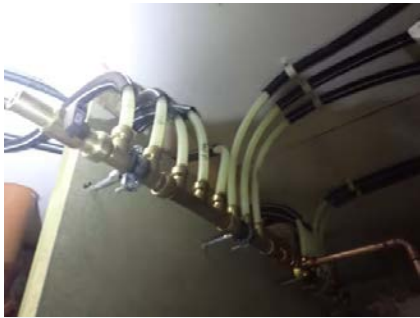
Rørfordeling i grovkjeller.
