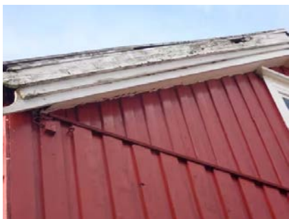
Vinds kier med råte.
