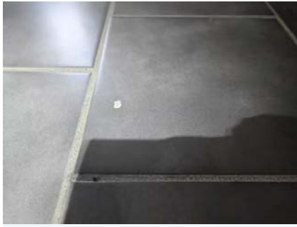
Skår i overflate gulvflis.
