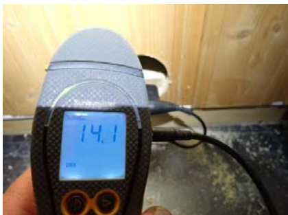
Fuktmåling i utforet vegg på kontor/kjellerstue.
