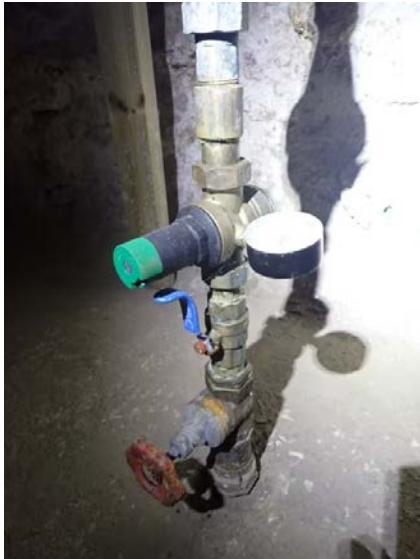
Stoppekrane i grovkjeller.
