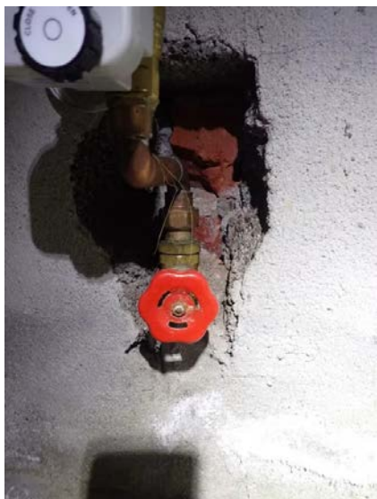
Stoppekrane i bod 3.
