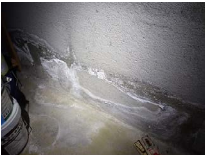
Salt/kalkutslag i overflater.
