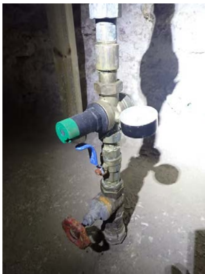
Stoppekrane i grovkjeller.
