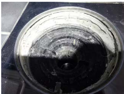
Sluk med synlig membran.
