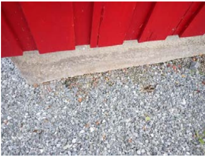
Tilløp til råte i nordvegg.
