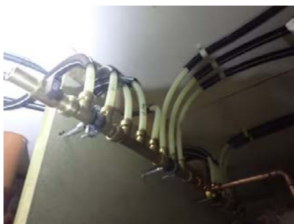
Rørfordeling i grovkjeller.
