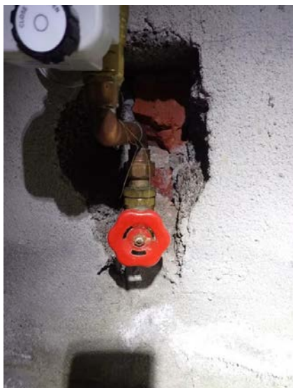
Stoppekrane i bod 3.
